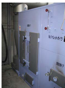
写真Ⅱ-5.3-4 ボイラ
