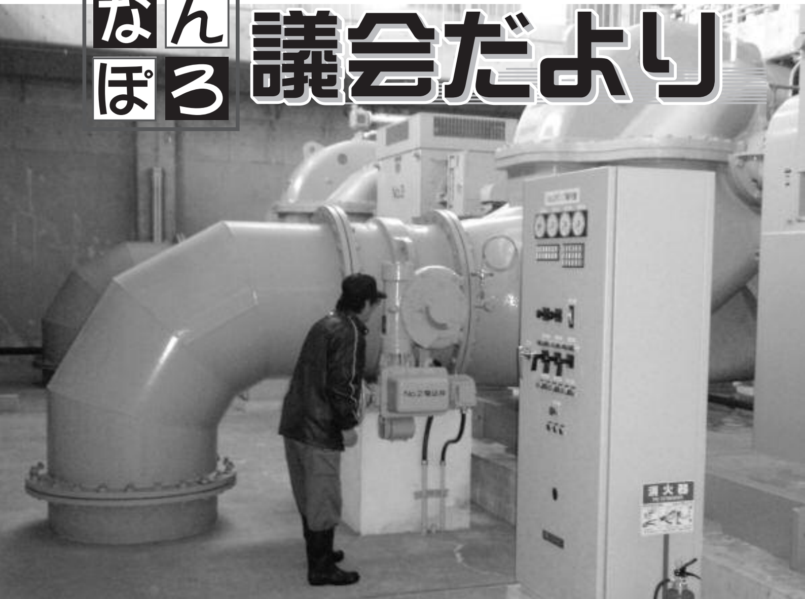
南幌向揚水機場内の様子
